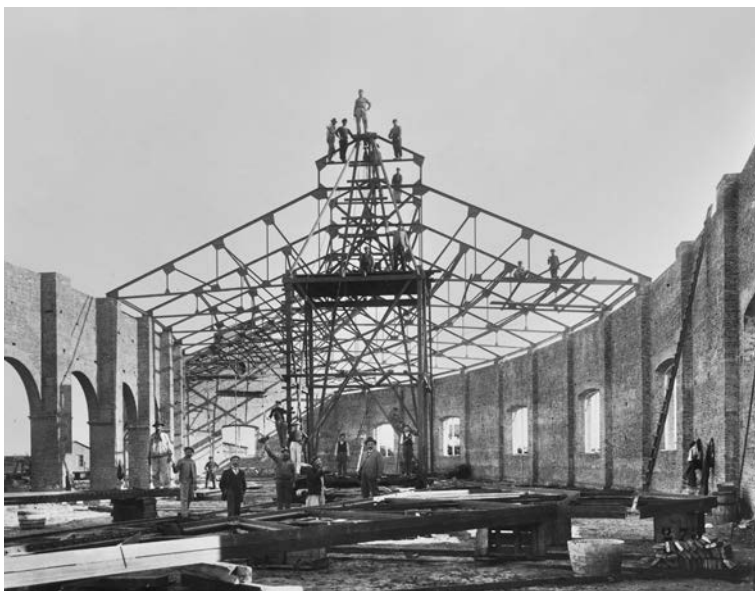
Figura 11. José Femminini. Santa Fe. Obreros trabajando en la construcción del galpón central de locomotoras del Ferrocarril de Santa Fe. Ca. 1905. Museo Regional Ferroviario de Santa Fe.
